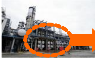
高効率熱交換器 入れ替えの例
